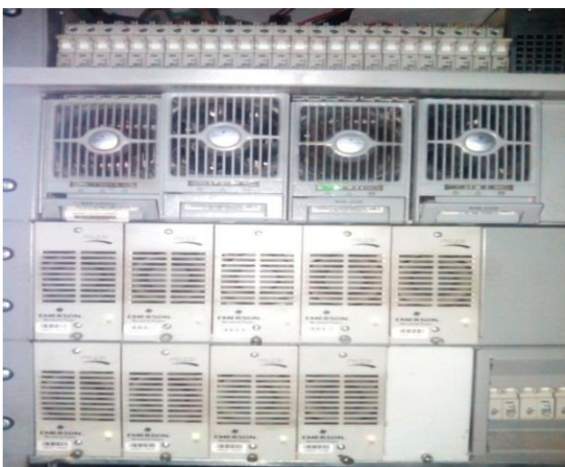
Fig-14: -48V and -24V Rectifier modules
