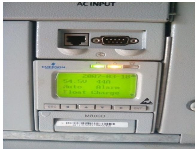
Fig-15: Rectifier Controller module
